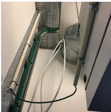
Gennemføring fra teknikrum til fælleshus.
