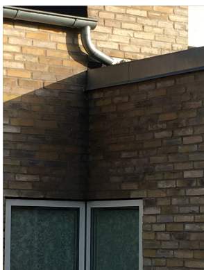
Opfugtet murværk ved Skyttestien 32.
