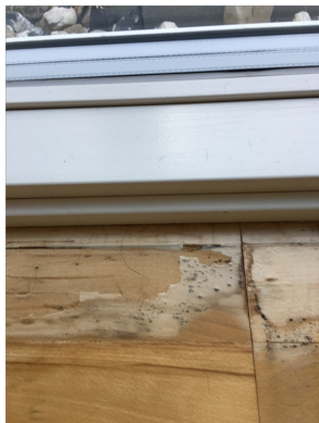
Skader på gulv omkring utæt vinduesparti - Mårvænget 57
