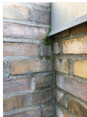
Opfugtet hjørne med algevækst.
