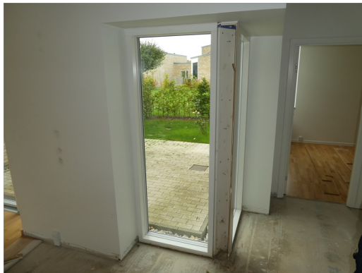
Skader på gulv omkring utæt vinduesparti - Mårvænget 57 (Destruktiv nedbrydning)
