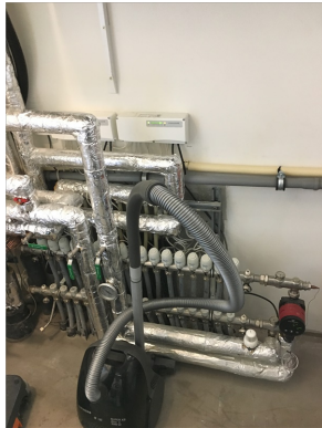
Rørbæring på kondensafløb i teknikrum.
