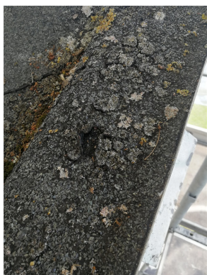
Tagpap på Mårvænget 75 (billedet er taget af EKAS under udførsel af destruktiv nedbrydning)
