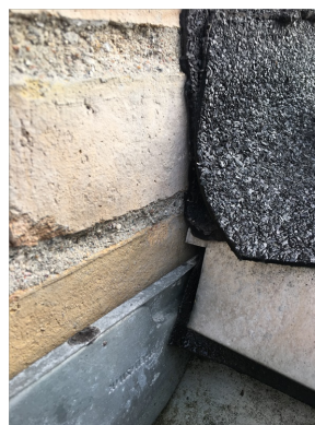
Påsvejst på i forsøg på at holde tagvand væk fra murværket skyttestien nr. 60.
