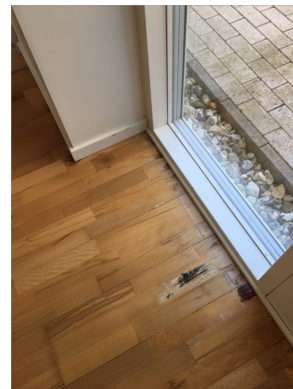
Skader på gulv omkring utæt vinduesparti - Mårvænget 57
