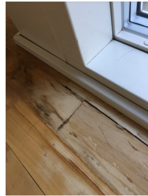
Skader på gulv omkring utæt vinduesparti - Mårvænget 57
