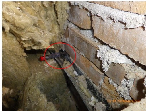
Porøse fuger i murværk på Mårvænget 75 (billedet er taget af EKAS under udførsel af destruktiv nedbrydning)
