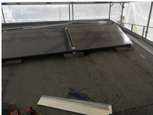
Tagpap på Mårvænget 75 (billedet er taget af EKAS under udførsel af destruktiv nedbrydning)
