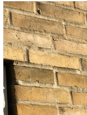
Revne i murværk over vindue på Skyttestien nr. 80
