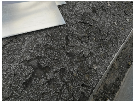
Tagpap på Mårvænget 75 (billedet er taget af EKAS under udførsel af destruktiv nedbrydning)
