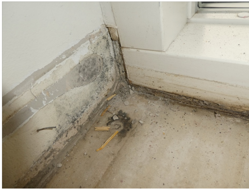
Skader på gulv omkring utæt vinduesparti - Mårvænget 57 (Destruktiv nedbrydning)
