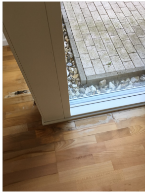
Skader på gulv omkring utæt vinduesparti - Mårvænget 57
