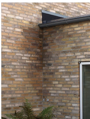
Opfugtet murværk ved Skyttestien 55.
