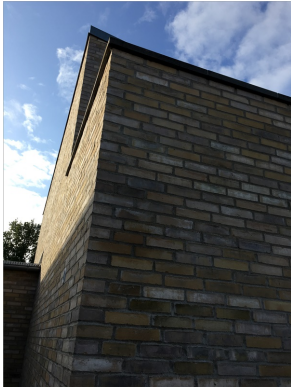
Ydervæg Skyttestien nr. 4 - Opfugning på hjørne.
