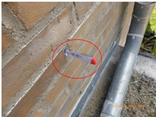
Porøse fuger i murværk på Mårvænget 75 (billedet er taget af EKAS under udførsel af destruktiv nedbrydning)
